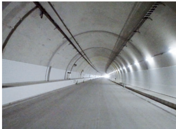
工事名：さがみ縦貫愛川トンネル(その2) 工事（神奈川県） 発注者：国土交通省関東地方整備局
