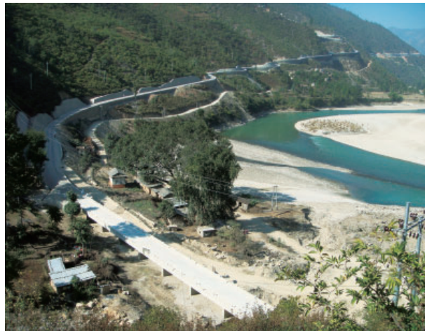
工事名：シンズリ道路建設計画第三工区2/2期後段（ネパール） 発注者：ネパール国公共事業交通省道路局
