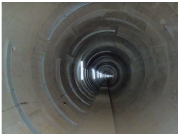
工事名：大阪北共同溝枚方・交野地区洞内設備他設置工事（大阪府） 発注者：国土交通省近畿地方整備局
