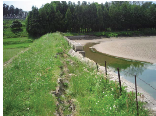
ため池地震被害(堂前池、福島県) 出典：平成23年(2011年)東北地方太平洋沖地震による 福島県のため池被災の特徴と応急対策、農研機構
