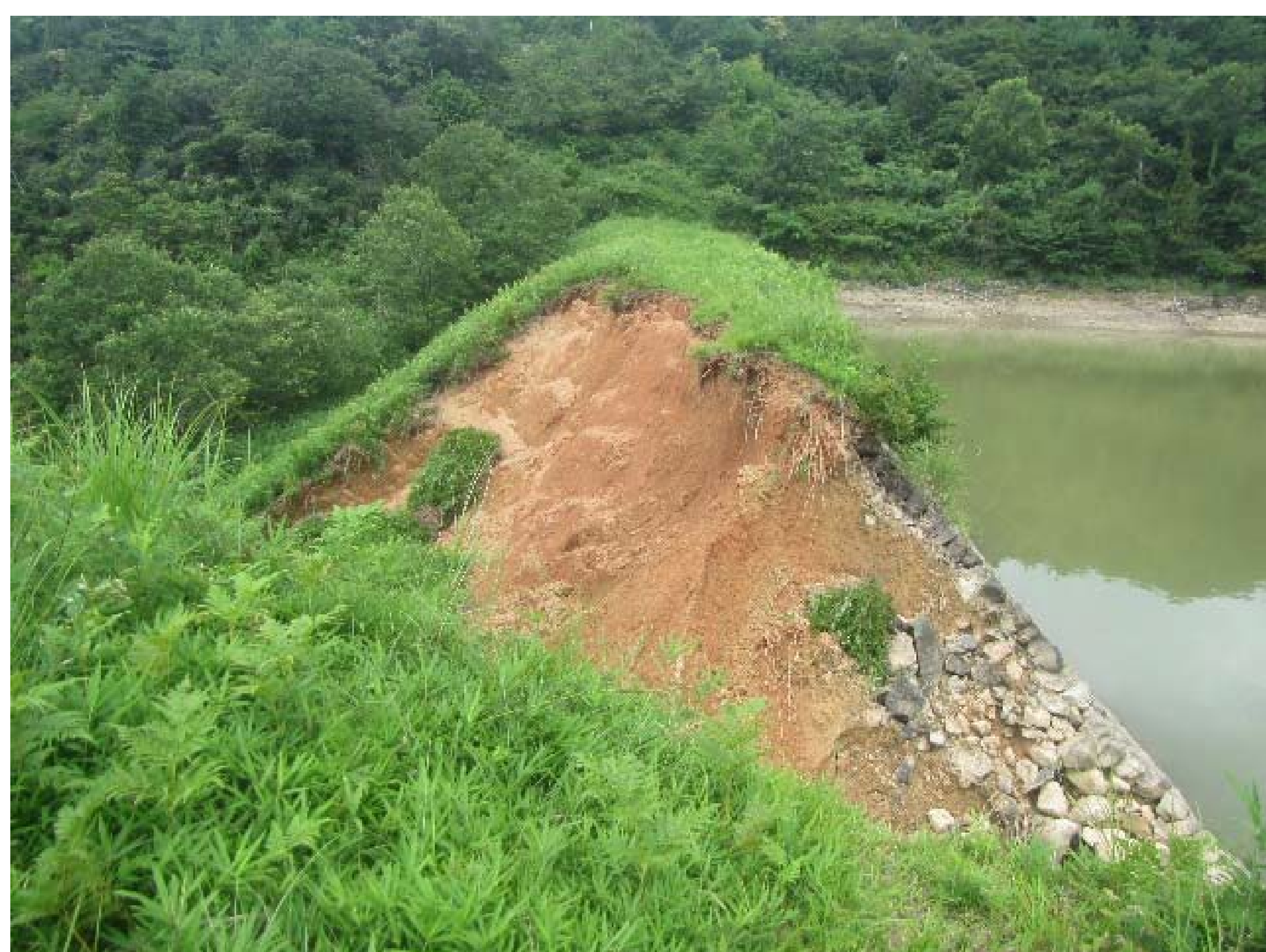
ため池豪雨被害（大田池、岡山県）
