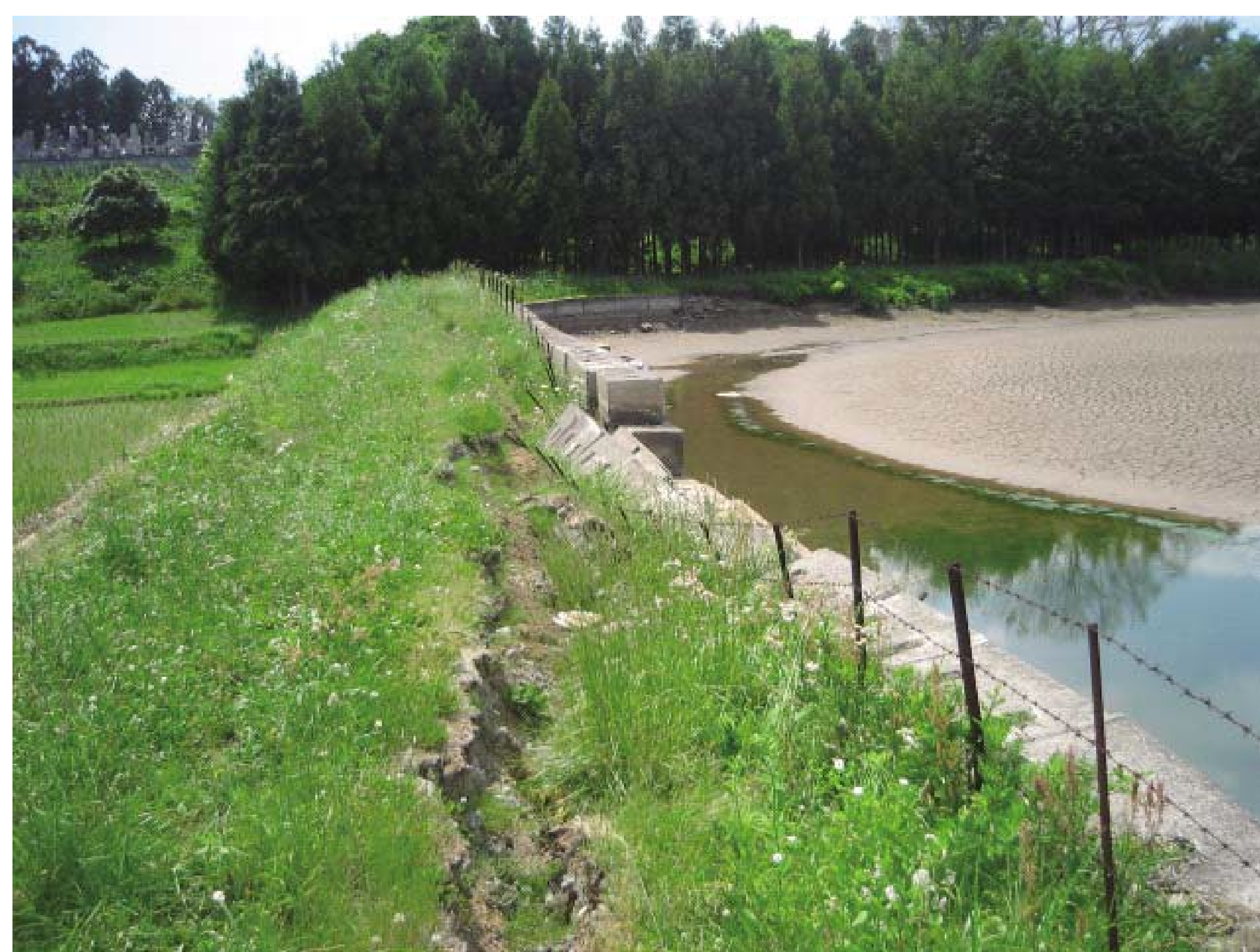
ため池地震被害（堂前池、福島県）
