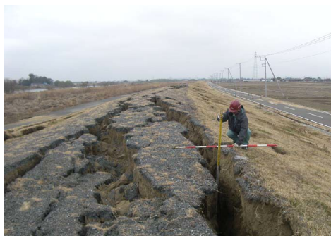
平成23年東北地方太平洋沖地震 堤防被害(那珂川、茨城県) 出典：直轄河川緊急復旧工事実施状況 (平成23年東北地方太平洋沖地震による河川被災箇所) 国土交通省 関東地方整備局河川部
