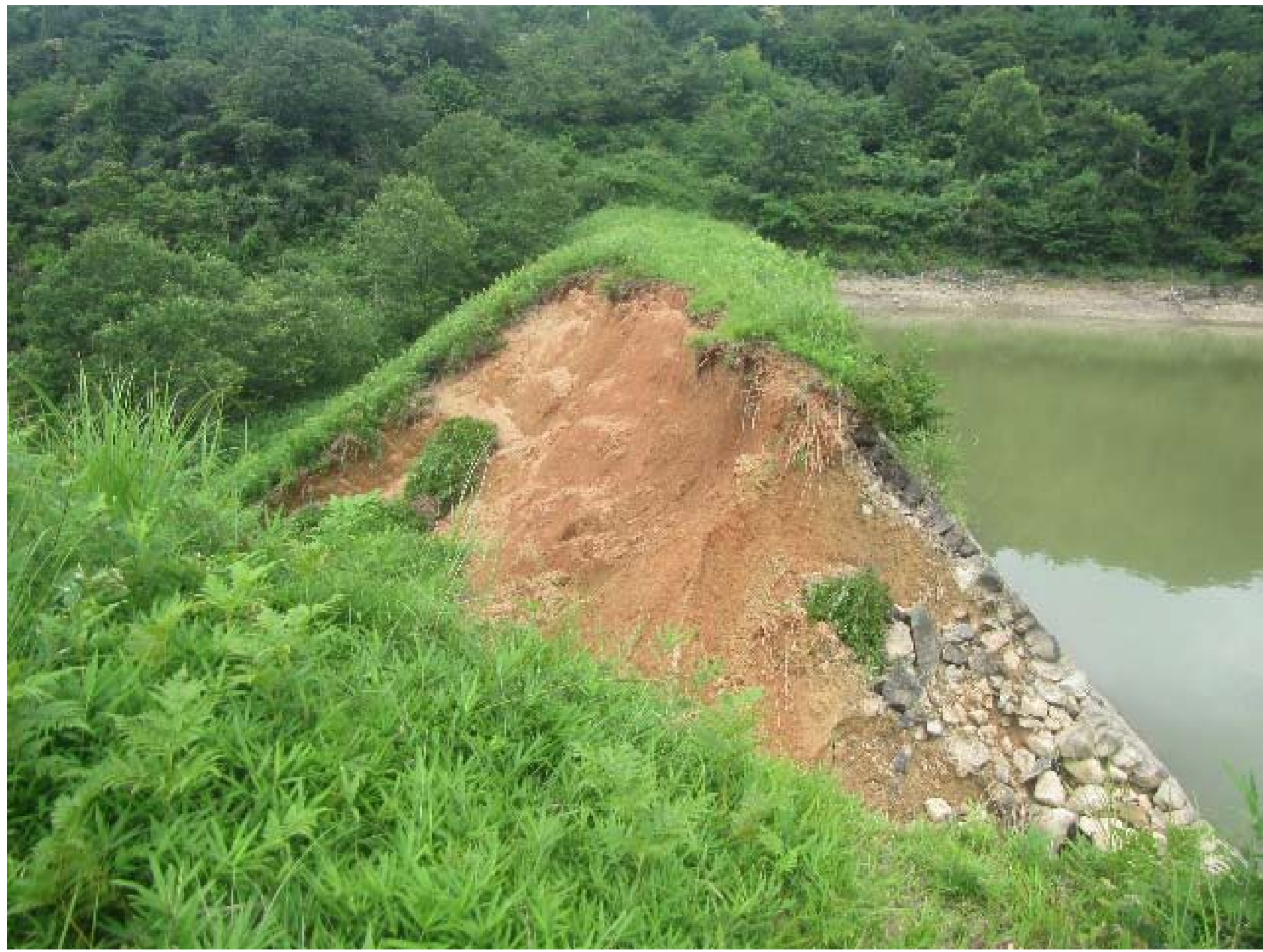
ため池豪雨被害（大田池、岡山県）
