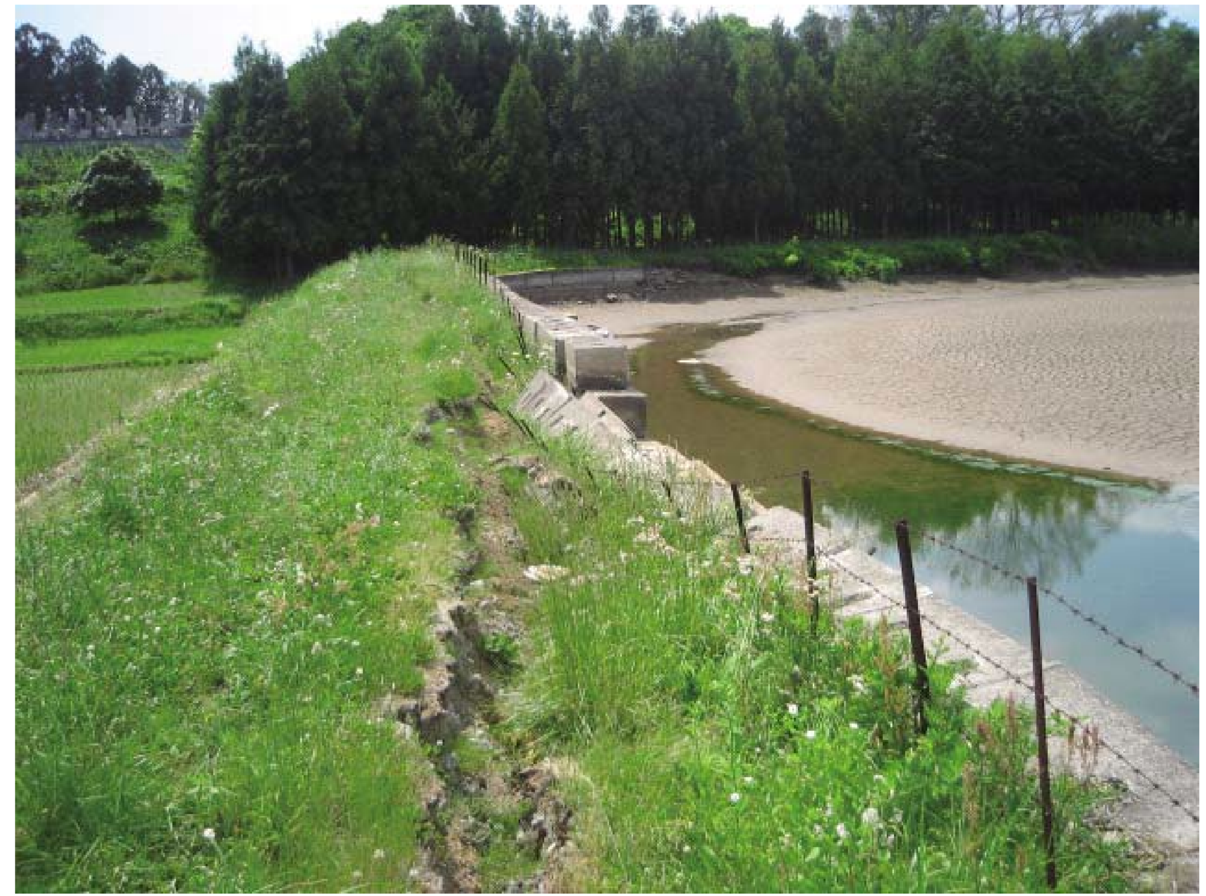
ため池地震被害（堂前池、福島県）
